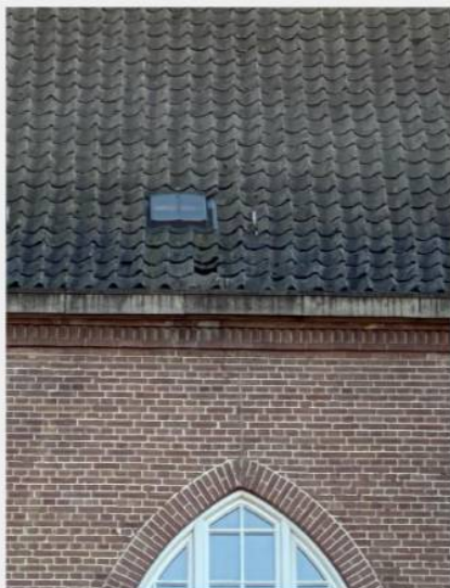
Een gat in het kerkdak .....
